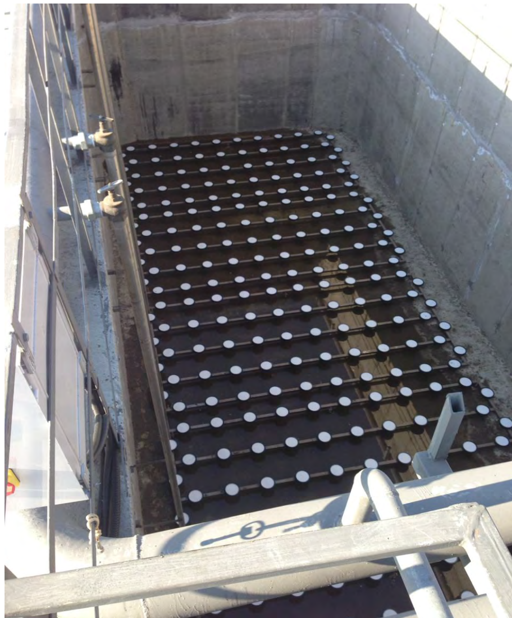
СИСТЕМА АЭРАЦИИ «БЕЛЭКПОЛЬ» НА ОЧИСТНЫХ СООРУЖЕНИЯХ КАНАЛИЗАЦИИ г. АНАПА (РОССИЯ)
